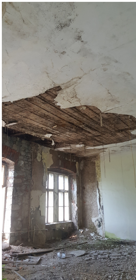
foto 57- planșeu peste etaj aflat în stare de precolaps- 2023
