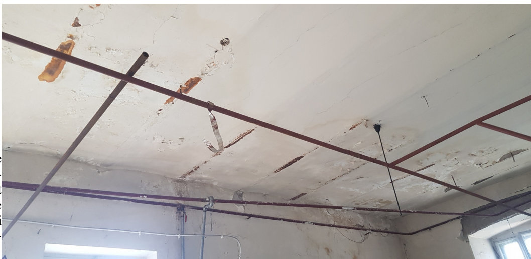
foto 60- planșeu pe bolțișoare la parter- umiditatea a afectat atât șinele metalice (se vede deja rugina), cât și tencuielile de pe bolți- 2023
