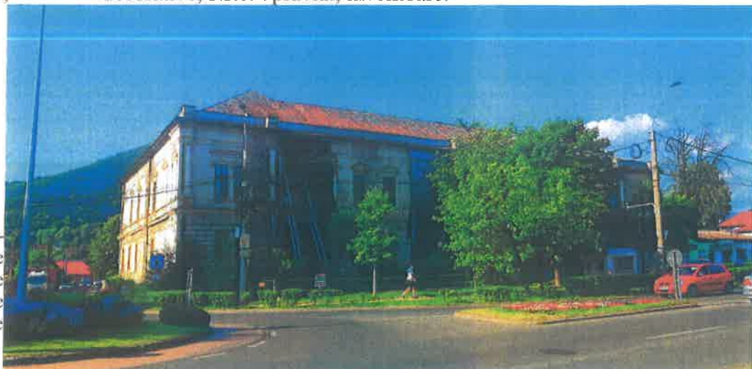
foto 42- clădirea fostei Școli de Fete în iunie 2023. Cele trei prelate negre acoperă porțiuni de clădire prăbușite
