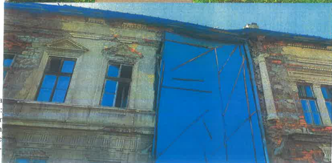
foto 44- degradarea fațadei principale: colaps total al unor travei și distrugerea elementelor purtate pe restul suprafeței fațadei- vara 2023
