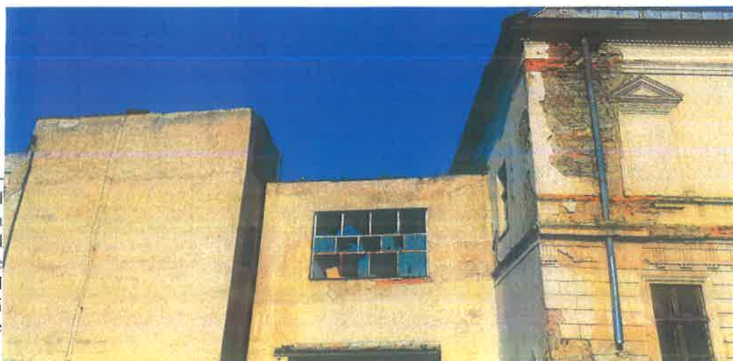
foto 48- conexiunea între corpul vechi și cel din perioada comunistă- se văd degradări grave cauzate de umiditate pe cel vechi și degradări cauzate de abandon pe ambele- vara 2023
